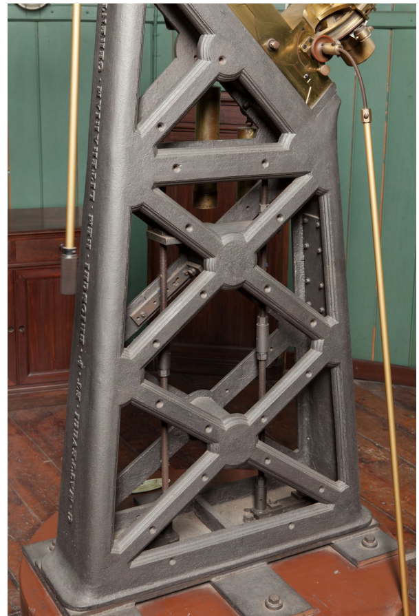
Figura 27: Il basamento del Merz 8', con i tiranti aggiunti per rinforzare la struttura dopo i danni subiti nel bombardamento del 1943.
